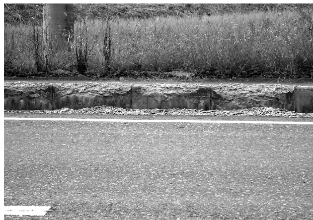
図1 山間部で凍害が生じた境界ブロック
